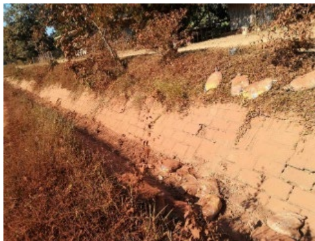
ຮູບທີ 1 ຮອຍແຫງຢູ່ຕາມຄອງເໝືອງ
