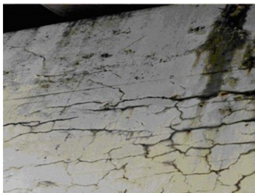
ຮູບທີ 58 ປະຕິກິລິຍາ ຄວາມເປັນດ່າງ-ຊີລິກາ (ASR) ໃນຄອນກຣີດ
