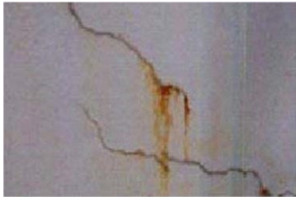
ຮູບທີ 57 ລະດັບ S-3; ຮອຍແຕກ ແລະ ການເປັນໝໍ້ງຽງ ຂອງເຫຼັກເສັ້ນພາຍໃນຄອນກຣີດ
