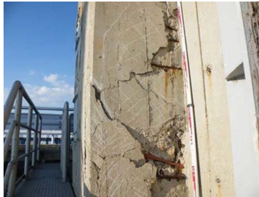
ຮູບທີ 55 ການແຕກແຫງຢ່າງຮຸນແຮງ ຂອງໂຄງສ້າງຄອນກຣີດເສີມເຫຼັກ
