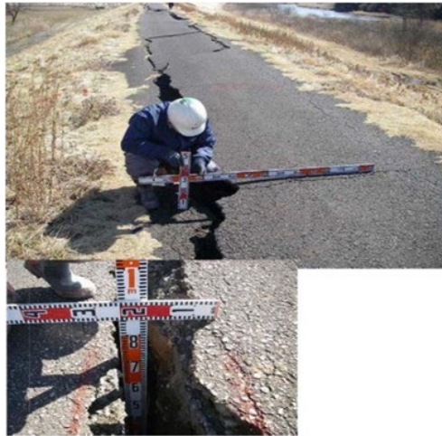
ຮູບທີ 46 ຮອຍແຕກຂະໜາດໃຫຍ່ ແລະ ຍາວບໍລິເວນສັນເຂື່ອນ
