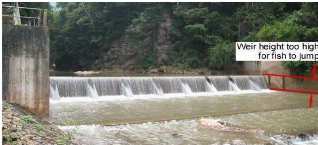
ภาพผนวกที่ 1.1 ลักษณะฝายที่ขวางกั้นลำน้ำซึ่งตั้งอยู่บนลำธารที่สูงซึ่งสูงเกินกว่าที่ปลาจะเดินทางผ่านไปได้
