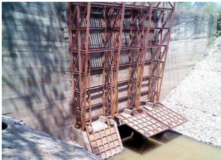
ภาพผนวกที่ 1.9 บานประตูระบายน้ำท่วมที่ติดตั้งบริเวณทางน้ำออกไปยังพื้นที่ชุ่มน้ำบริเวณ Xe Bang Fei
