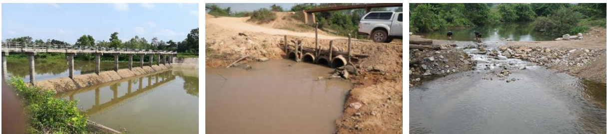
ภาพที่ 15 ฝายที่มีความสูงต่ำกว่า 1 เมตร (ซ้าย) ท่อระบายน้ำที่มีความกว้างน้อยกว่า 50% ของความกว้างแม่น้ำ (กลาง) และทางข้ามที่มีระดับความสูงต่ำกว่า 0.3 เมตร (ขวา)
