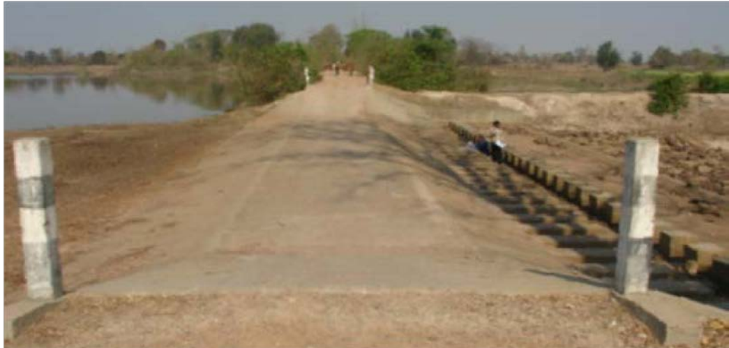
ภาพผนวกที่ 1.2 ฝ่ายที่ตั้งอยู่บริเวณช่องทางออกของน้ำที่เปิดออกไปยังพื้นที่ชุ่มน้ำ Xe Champhone ฝ่ายที่มีบานประตูระบายน้ำ (Gated Weirs)
