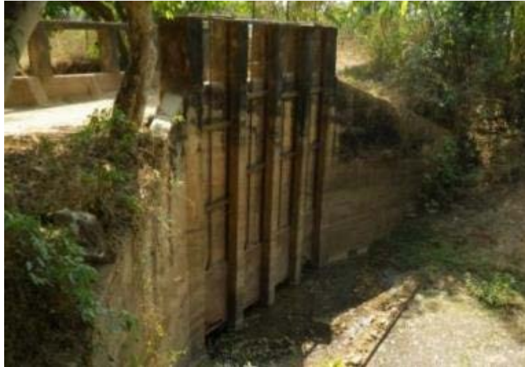
ภาพผนวกที่ 1.7 อาคารบังคับน้ำแบบบานประตูเหล็กที่ใช้ในการบังคับน้ำบริเวณทางน้ำออกของพื้นที่ชุ่มน้ำ
