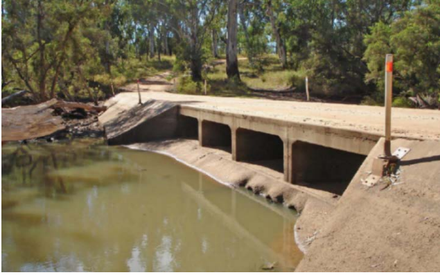
ภาพผนวกที่ 1.12 ท่อระบายน้ำที่ขวางกั้นการไหลของน้ำ และก่อให้เกิดระดับน้ำที่มีความแตกต่างกันมากที่บริเวณลำน้ำที่ไหลผ่านใต้ทางข้าม
